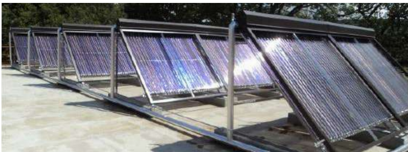
Scuola S. Casciano | Siena - Impianto solare con pannelli 1100 HP
