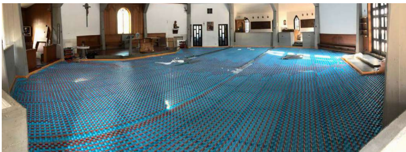
Chiesa | Roma - Impianto radiante a pavimento con pannello Variplus
